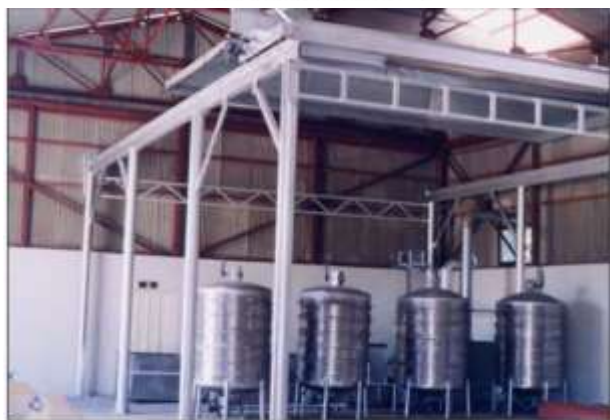
• 훈자·건조 시설의 1단계 설치
